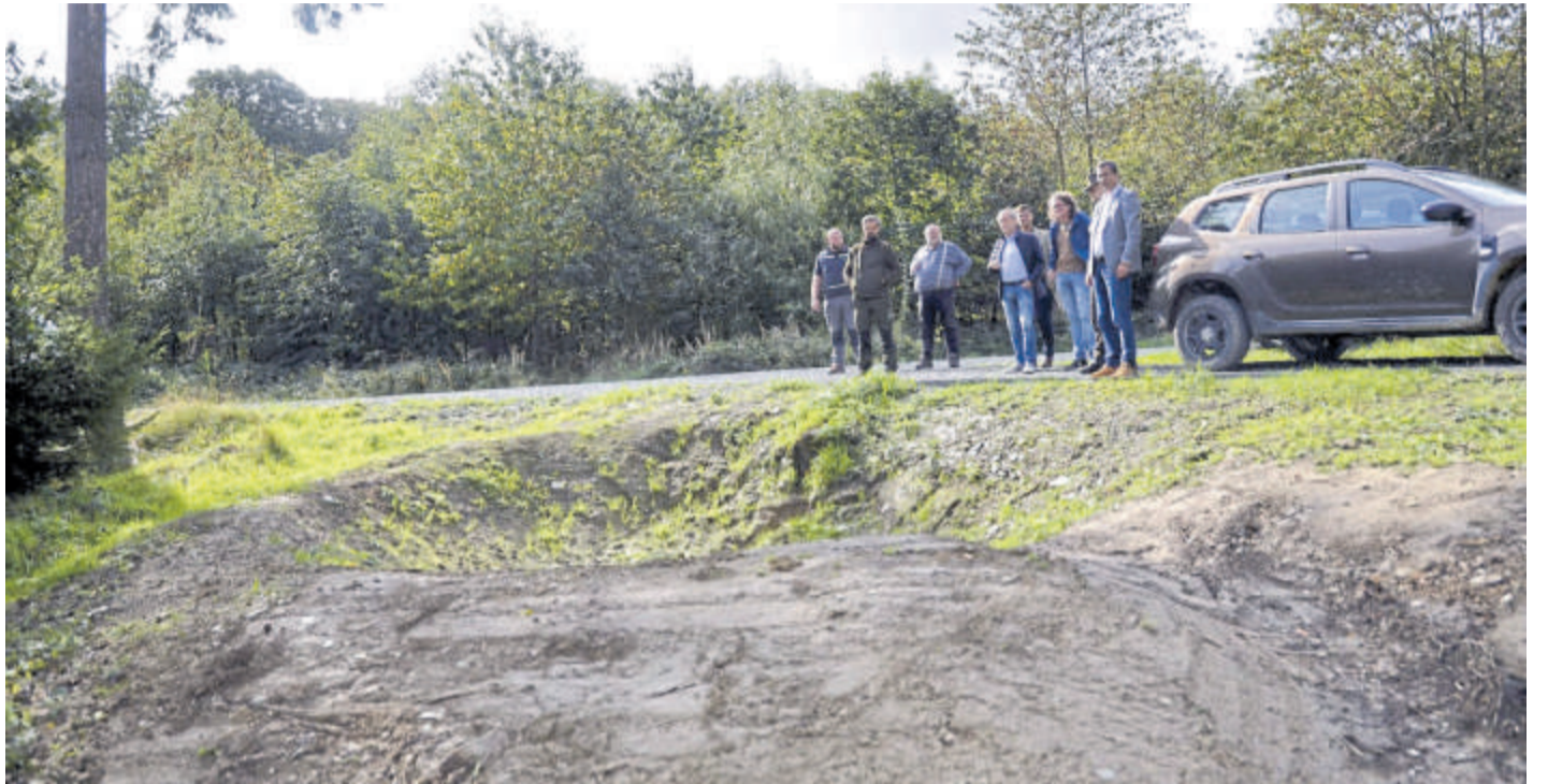
Im Mühlwald wird ein weiteres Großbiotop entwickelt. Verantwortliche aus Stadt und Kreis sowie weitere Unterstützer des Projekts besichtigen den Baufortschritt. Im Bild zu sehen ist die obere Wasserrückhalte mulde. FOTO: SALTENBERGER
